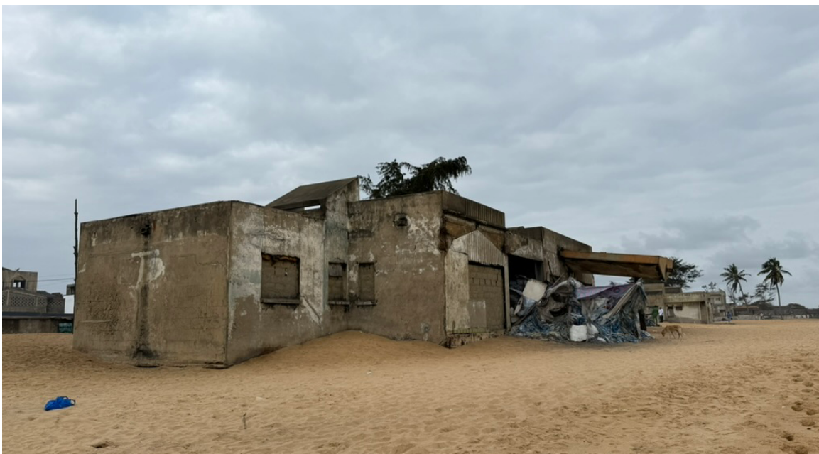
Infrastructure endommagée par l'érosion sur la côte béninoise un rappel saisissant de l'urgence de l'adaptation climatique pour les communautés africaines.
